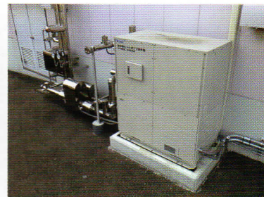
地中熱ヒートポンプ(室外機)
